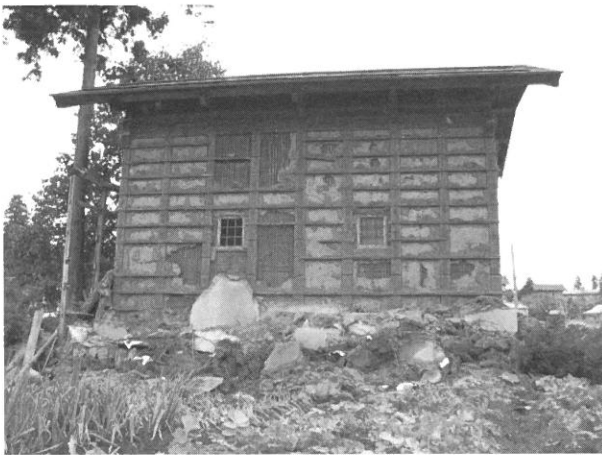
図 1 外壁がすべて崩れ落ちた川西町の土蔵
